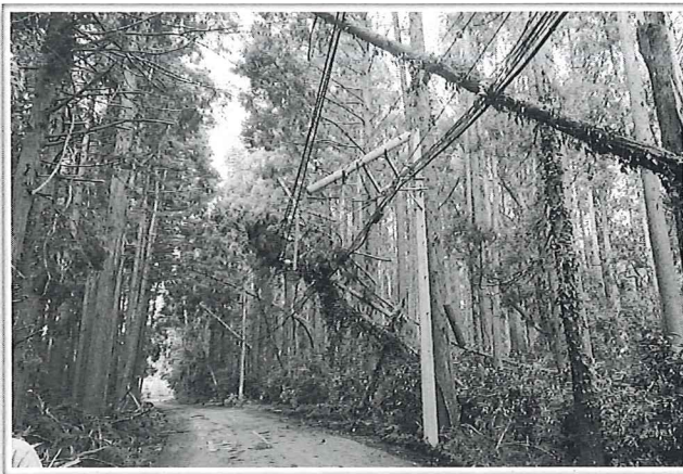
倒木で折れてしまった電柱
